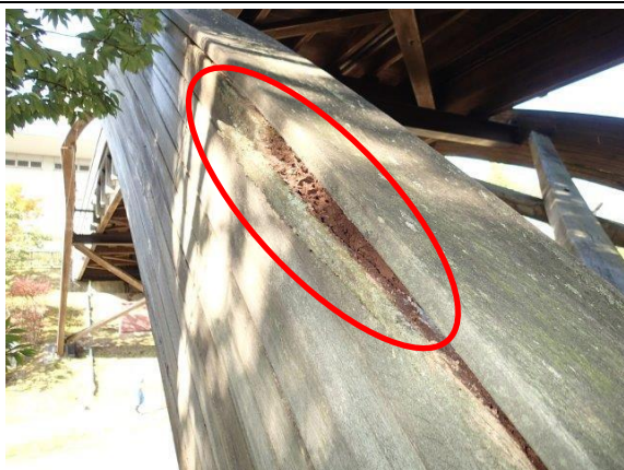
腐朽した後、クロアリの巣になっている。
