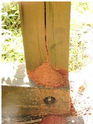
柱基部に蟻土が現れている。
