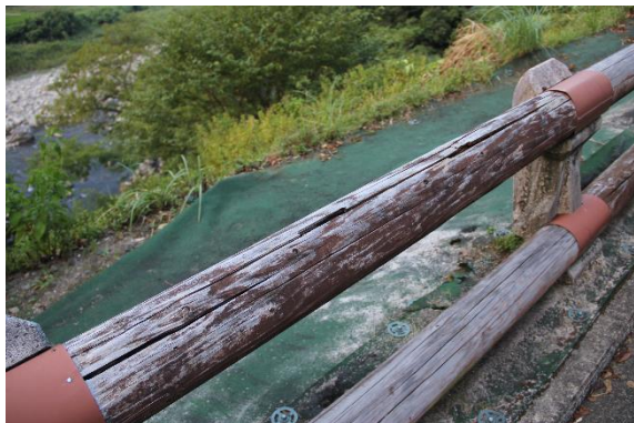
割れているだけに見えるが内部はほぼ腐朽している。
