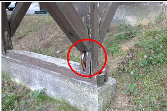
斜材取り付け箇所の下部が腐朽している。
