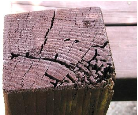
高欄柱頂部に蟻害が現れている。
