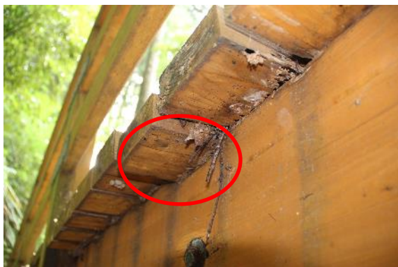
主桁材と床版材の接触面が腐朽し、床版材が沈んでいる。
