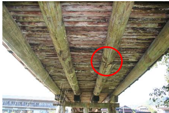
桁が曲げ破壊している。
