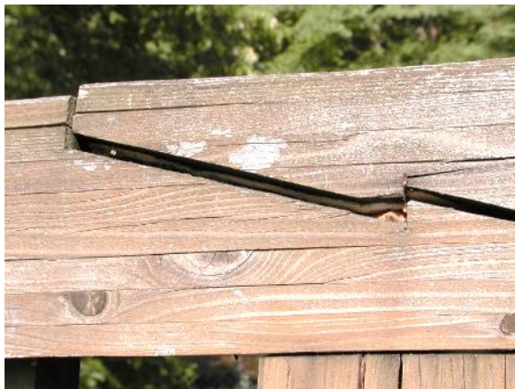
接合部分の隙間から蟻土が見える。
