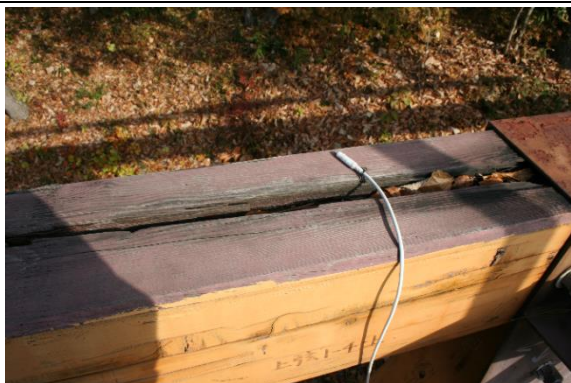
トラス上弦材のわれから内部の腐朽が生じている。
