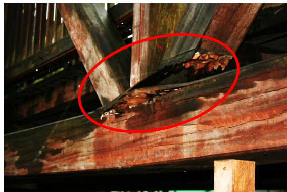
トラス格点部が腐朽により破壊している。
