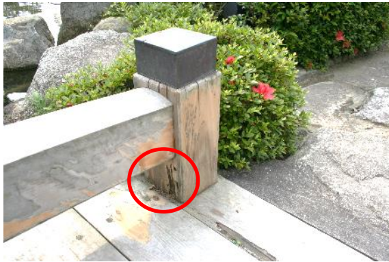
親柱の基部に蟻害が見える。
