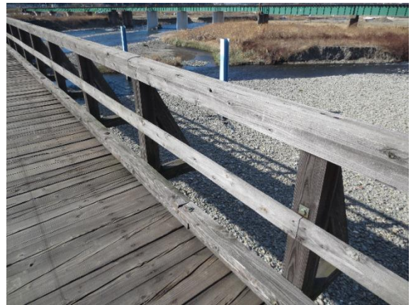
床版の上面にわれが生じている。
