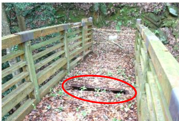
床版材が折損・脱落している。
