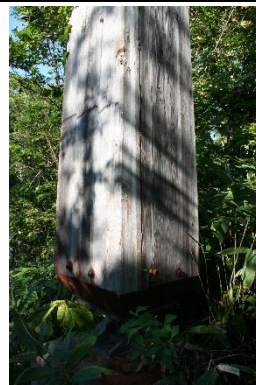
柱部材にわれが生じている。進行に注意する必要がある。
