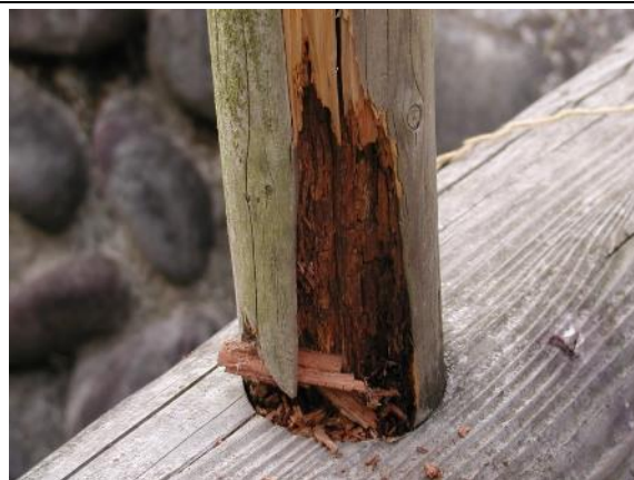
高欄柱の基部。水が溜まりやすい下縁部が腐朽している。
