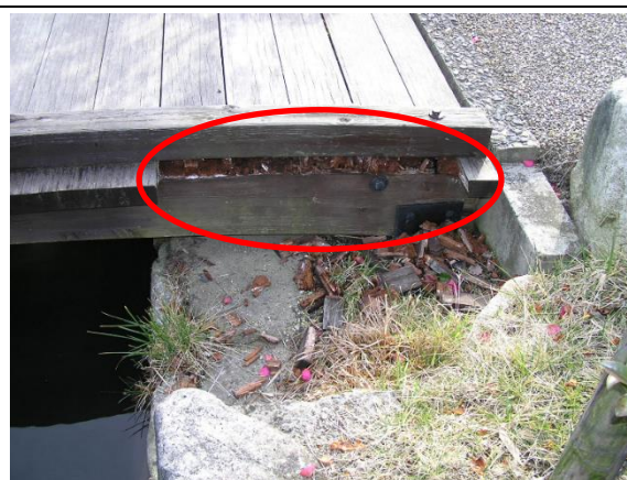
地覆下の床版が腐朽し、張出部が折れている。ここに脚をかけたためと考えられる。
