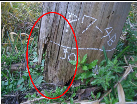
橋脚の地際部は腐朽しやすい。
