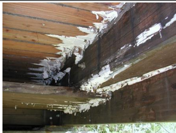
床版裏面の木材腐朽菌。これが見られる場合、部材内部の腐朽が疑われる。
