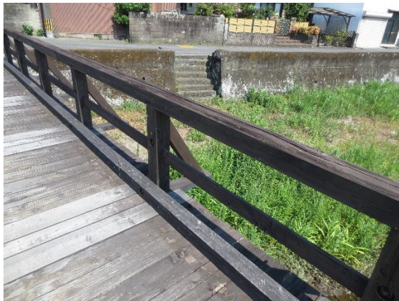
高欄の上面にわれが生じている。
